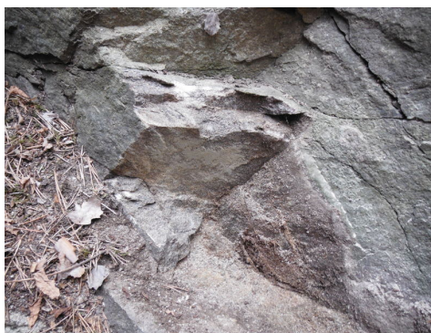
(f) Sede di distacco di un cuneo di roccia / Ausbruch eines Felskeils
