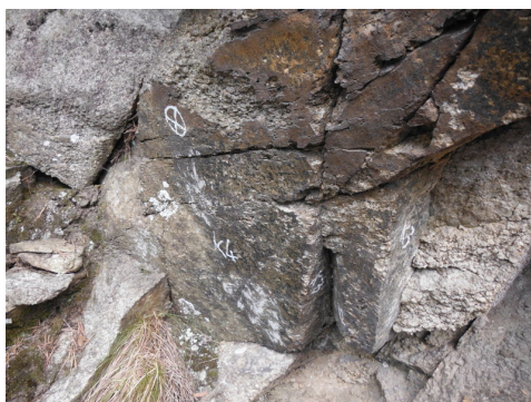
(e) Discontinuità K4 a reggipoggio / Hangeinwärts gerichtete Trennflächen K4
