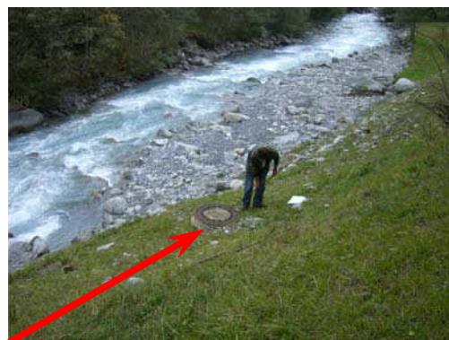
Foto 80 - Anschlussschacht orographisch rechts des Suldenbachs
