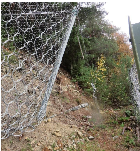
Foto 3: Elastische Barriere- Maccaferri: Energiehaltevermögen 3000 kJ; km 1+010-1+120./ Barriera deformabile - Maccaferri, capacità di trattenuta di energia 3000 kJ; km 1+010-1+120
