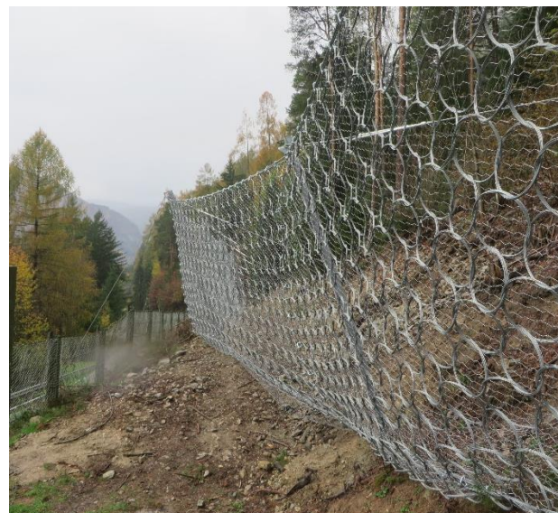
Foto 4: Elastische Barriere - Maccaferri: Energiehaltevermögen 2000 kJ; km 0+930-0+960./ Barriera deformabile - Maccaferri, capacità di trattenuta di energia 2000 kJ; km 0+930-0+960
